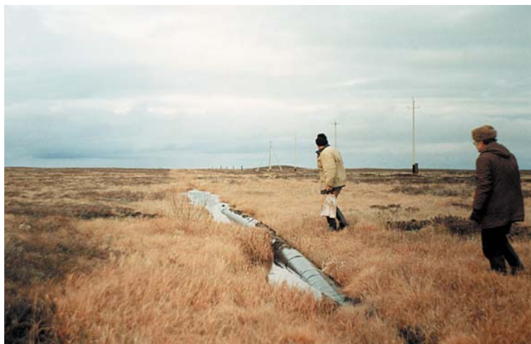
Рис. 3. Выпучивание конденсатопровода в период эксплуатации (1997 г.)
