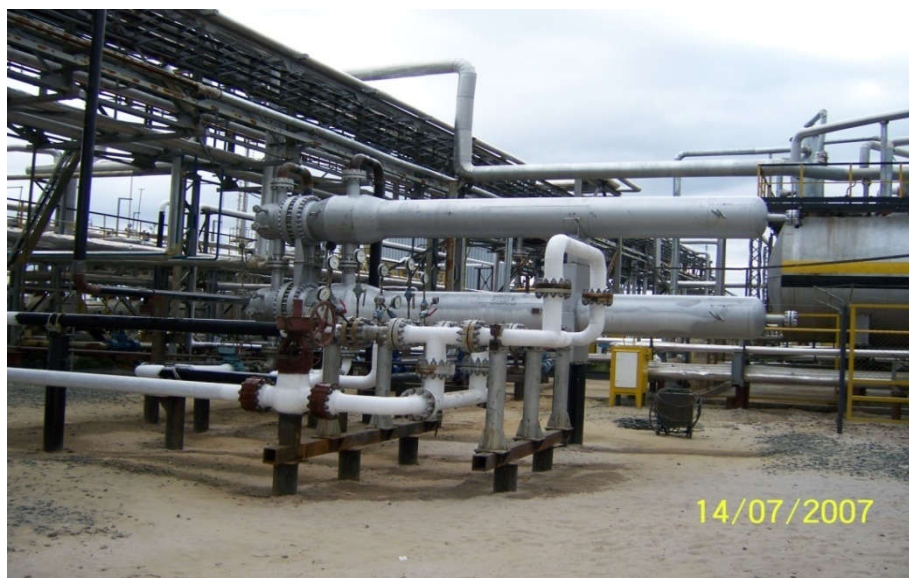
Рис. 4. Установка 3S-сепарации на УКПГ Губкинского месторождения ОАО «Роснефть»
